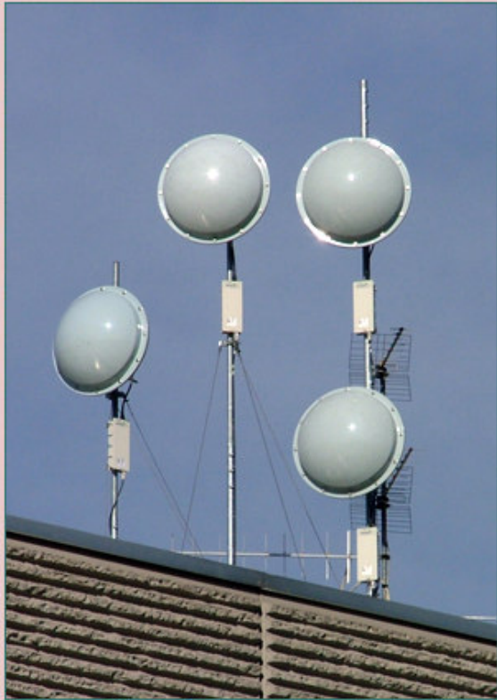
Infrastruttura esistente con B100 Alvarion
